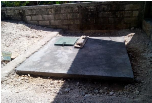
Gambar 4. Bak penampungan air di Paud Viadorosa
